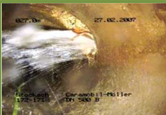
undichter Stutzen vor der Sanierung
