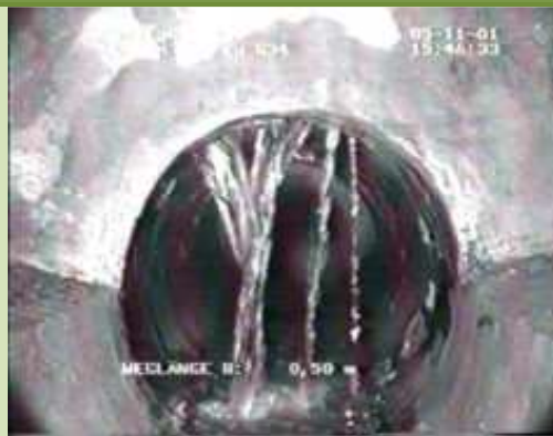
Grundwasserzulauf an Rohrmuffen
