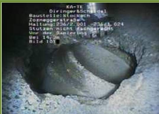
Einlaufstutzen vor der Sanierung
